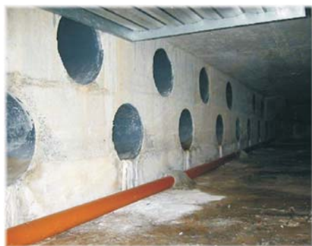
Entrée d'air d'un puits canadien sur plénum (Organisation Mondiale de la Météorologie à Genève, Suisse)
